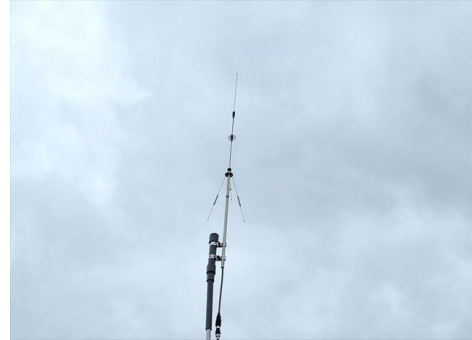
屋上仮設アンテナ
